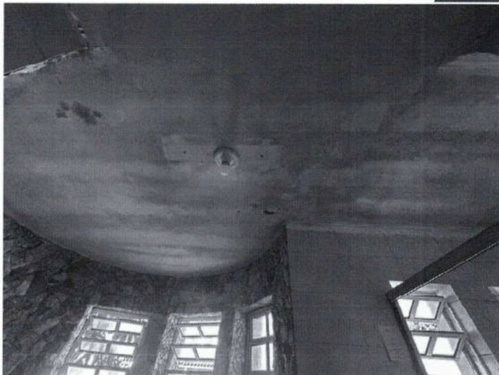
Primeiro pavimento – paredes com marcas de infiltração, manchas, adesivos e sujeiras, teto com mofo
